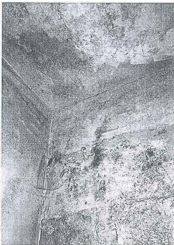
FOTO 12. Degradări la interior - bucătăria
