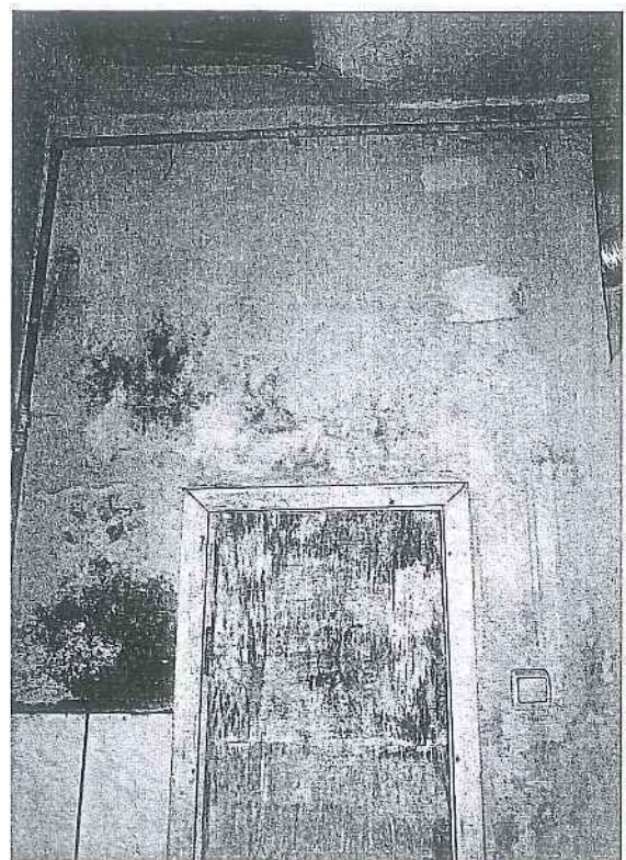
FOTO 13. Degradări la interior - bucătăria
