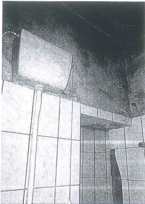
FOTO 10. Degradări la interior - baia
