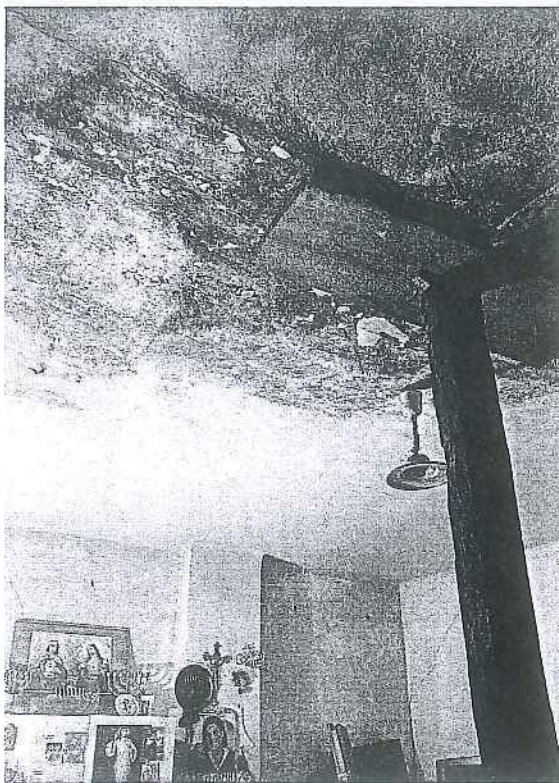
FOTO 8. Degradări la interior - camera
