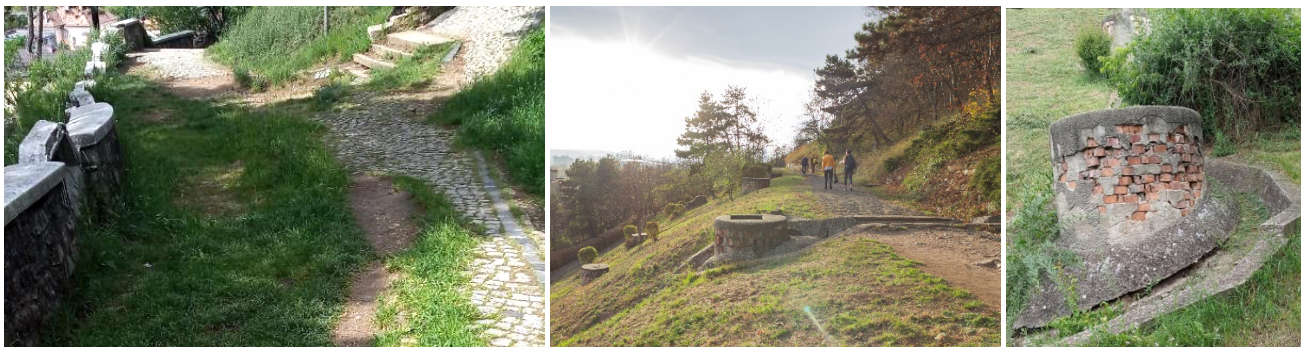
Figura 2 – Situația existentă – elemente degradate
