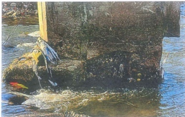
Poza 4 Cumulare de degardări la pila dinspre mal drept
