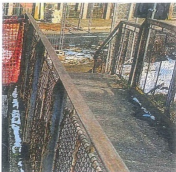
Poza 11 Lipsa dispozitivului de acoperire a rosturilor, degradarea parapetului
