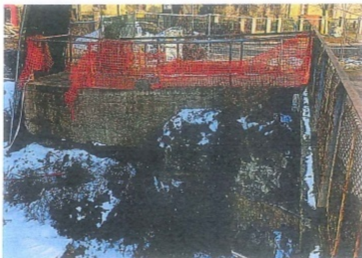
Poza 9 Lipsa scărilor de acces, caziurilor, racordare defectuaosa
