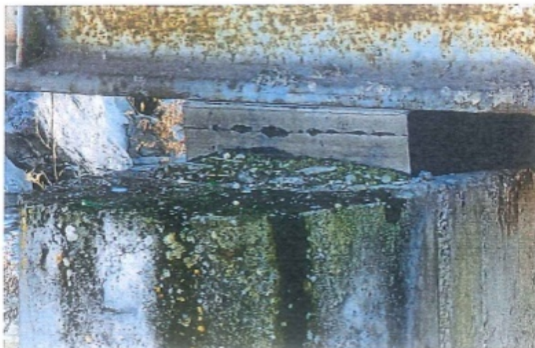
Poza 5 Lipsa dispozitivelor antiseismice, aparate de reazem cu praf si murdarie
