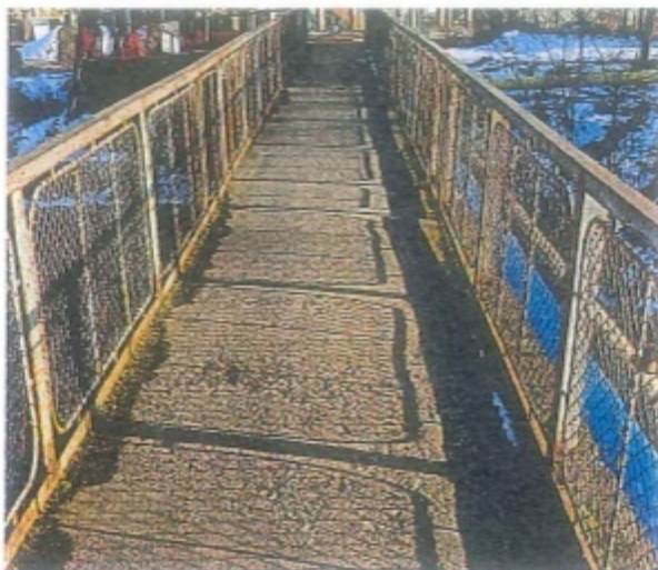
Poza 10 Neasigurarea pantei de scurgere a apelor pe pasarela; Lipsa căii pe pasarela
