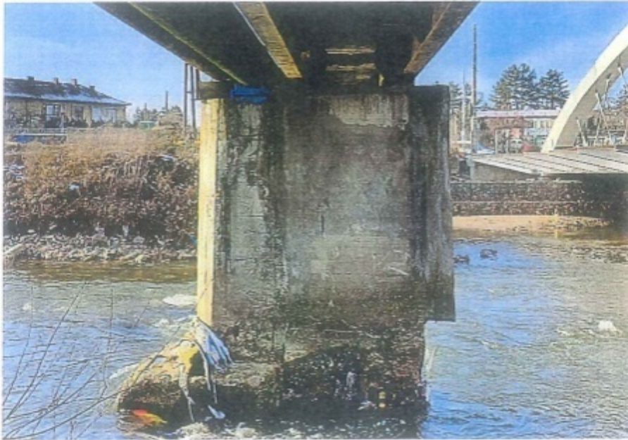
Poza 3 Cumulare de degardări la pila dinspre mal drept
