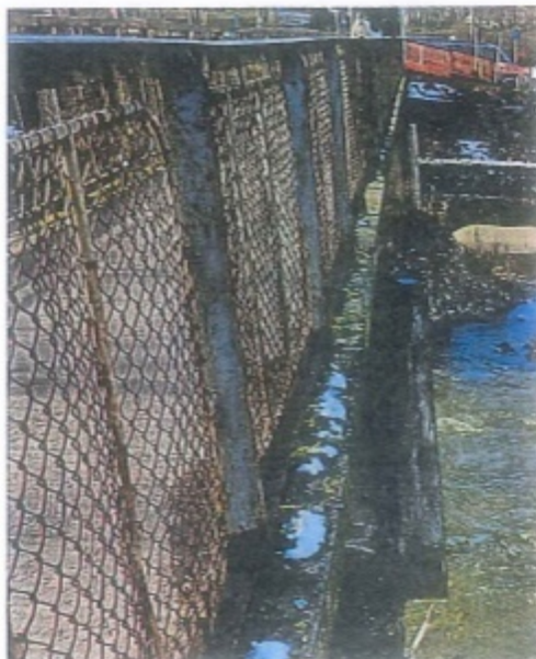
Poza 12 Prinderea necorespunzătoare a stălpilor parapetului
