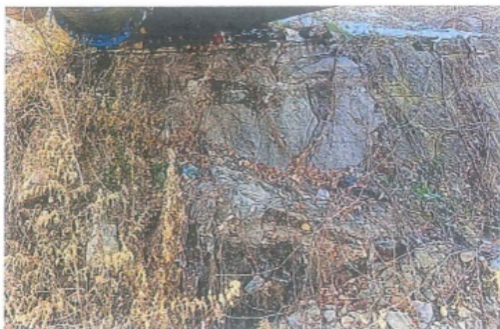
Poza 6 Distrugerea parțială a lucrărilor de apărare
