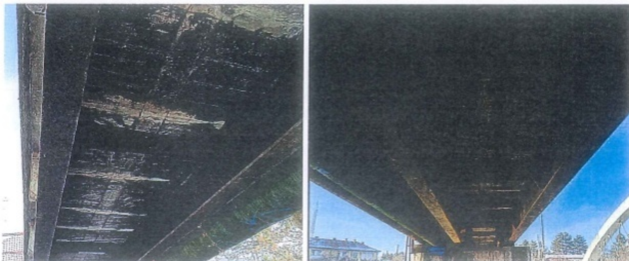
Poza 2 Culoare neuniforma pe placa de monolitizare, infiltrații, efflorescențe
