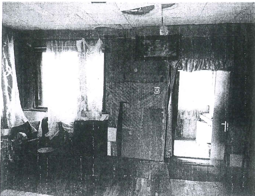
Foto nr. 7 – Aspect degradări interioare
