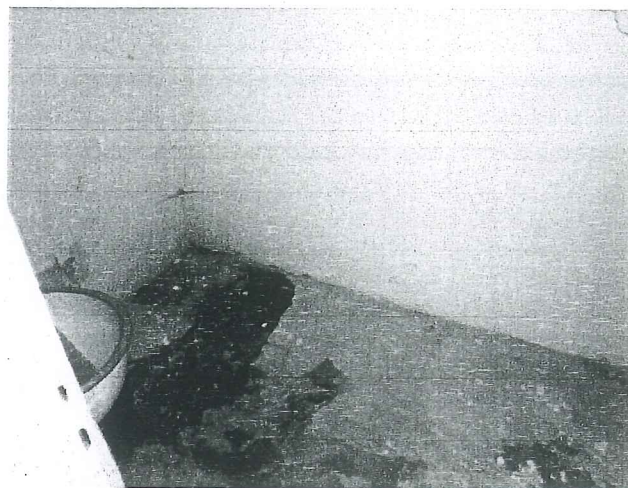
Bucătărie cu degradări
