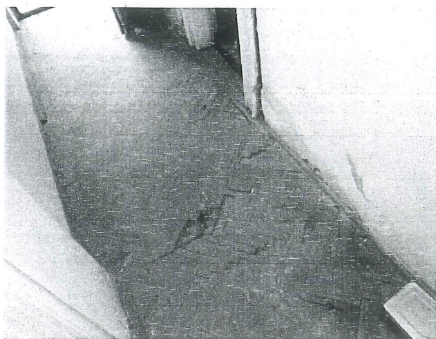
Degradări parchet hol
