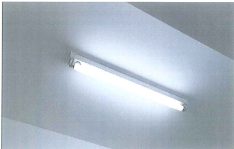
Figură 8 Corp de iluminat
