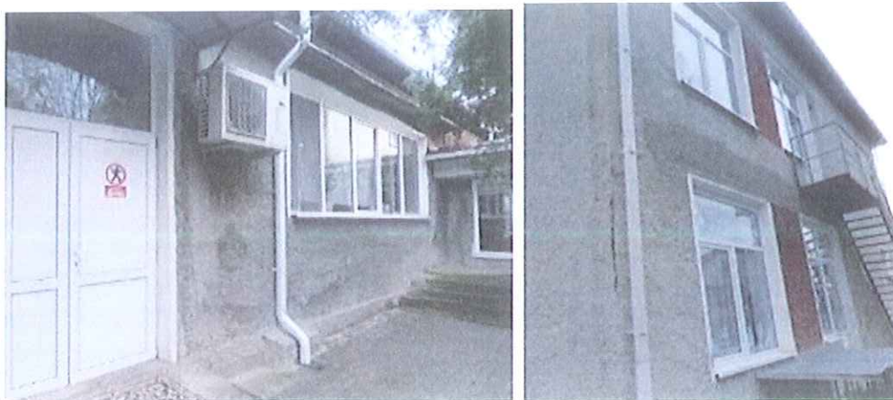
Figura 60. Burlane și climatizoare care vor trebui redislocate
