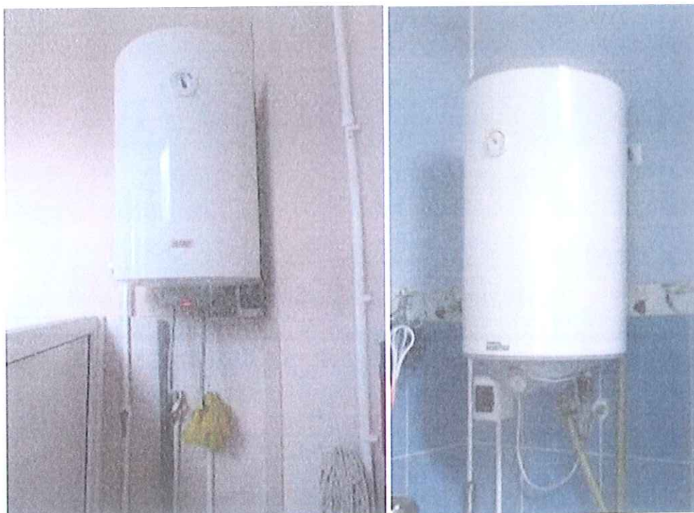
Figura 26. Imagini foto a boilerului electric
